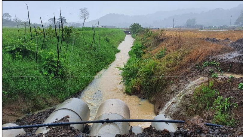
Batería de alcantarillas para paso de la quebrada en el sector norte del AP, vista al cauce excavado en los materiales naturales de la zona, el AP se aprecia a la derecha de la fotografía
