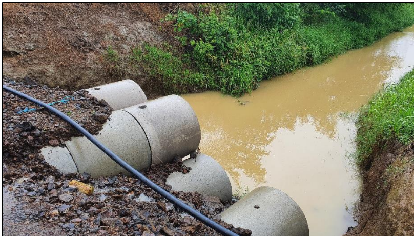
Batería de alcantarillas para paso de la quebrada en el sector sur del AP
